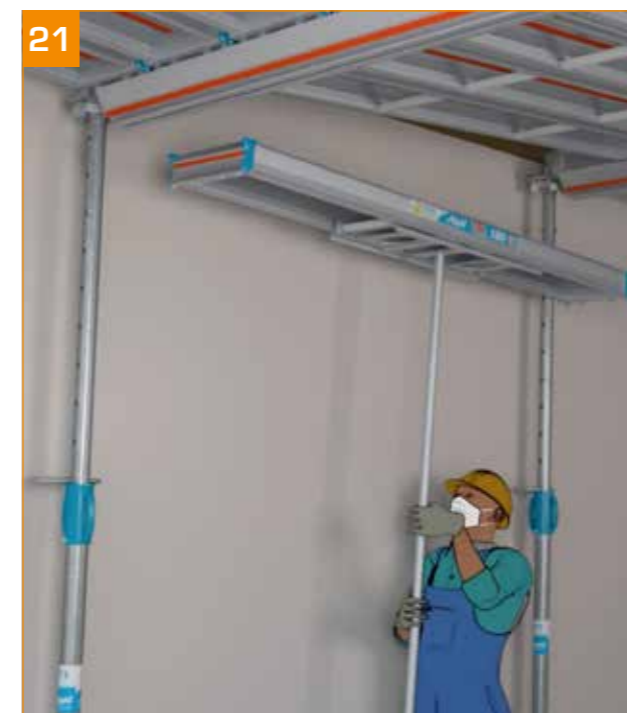
21 - Décoffrage de la dalle : enlever les panneaux Éco+ à l'avancement à l'aide de la TopPerche Éco.
