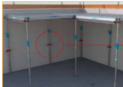
- La mise en place de cette bride peut se faire avant ou après le positionnement de l'étais.
