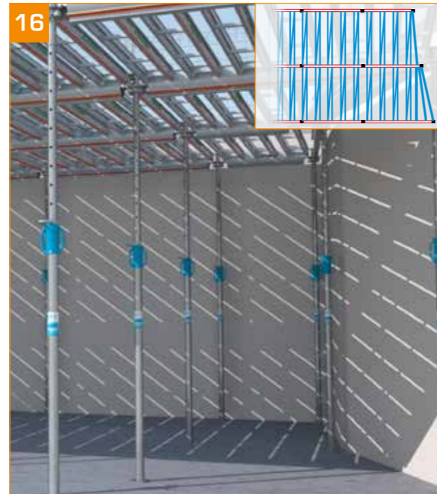
- Affiner la mise à niveau à l'aide d'un niveau laser ST par ST. - Une pige suspendue au coffrage permet à 1 seul homme d'effectuer le réglage avec le niveau laser. - Effectuer un dernier contrôle du verrouillage des têtes à cette étape.
